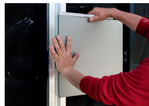
Auf Aluprofilen werden die Fassadenplatten aufgenietet. Gemäß Montageleiter Bösler ein Material für die Ewigkeit. Hier demonstriert er die Positionierung an einem Musterstück.
