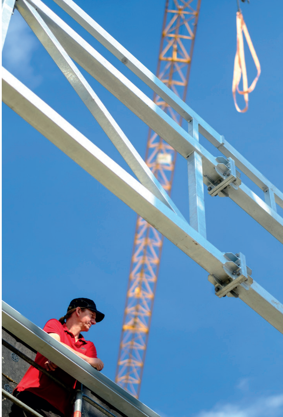
Feierabend in Sicht. Rudi Bösler und die massive Konstruktion des vorkragenden Dachs. Später wird sie die Fassadenplatten tragen.
